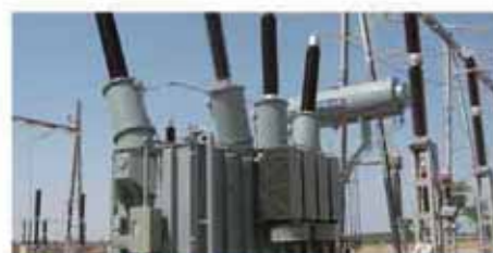
Буркина-Фасо: силовой трансформатор для Fordlum
