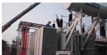
Бангладеш: силовой трансформатор для Aggreko
