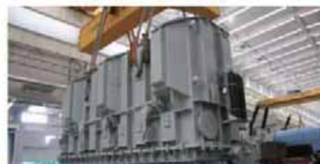
Пуэрто-Рико: трансформатор USA230kV 570MVA
