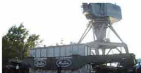
Сербия: трансформатор 400kV 400MVA
